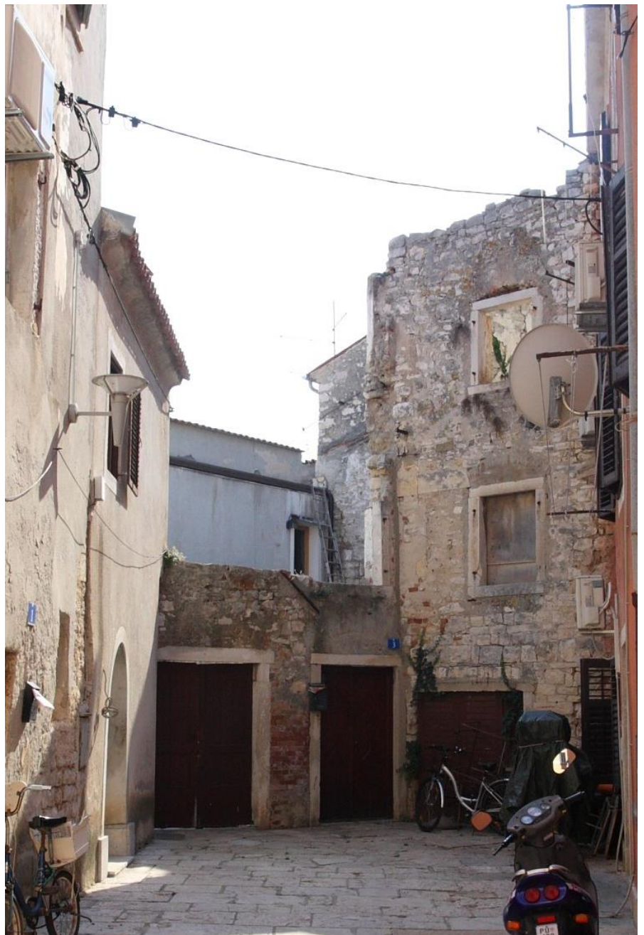
Primjer zapuštene povijesne građevine u Ulici tornja
